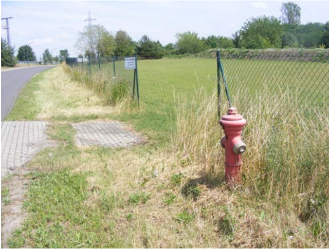
Bild – vorhandener Hydrant im Bereich der nördlichen BP-Grenze
