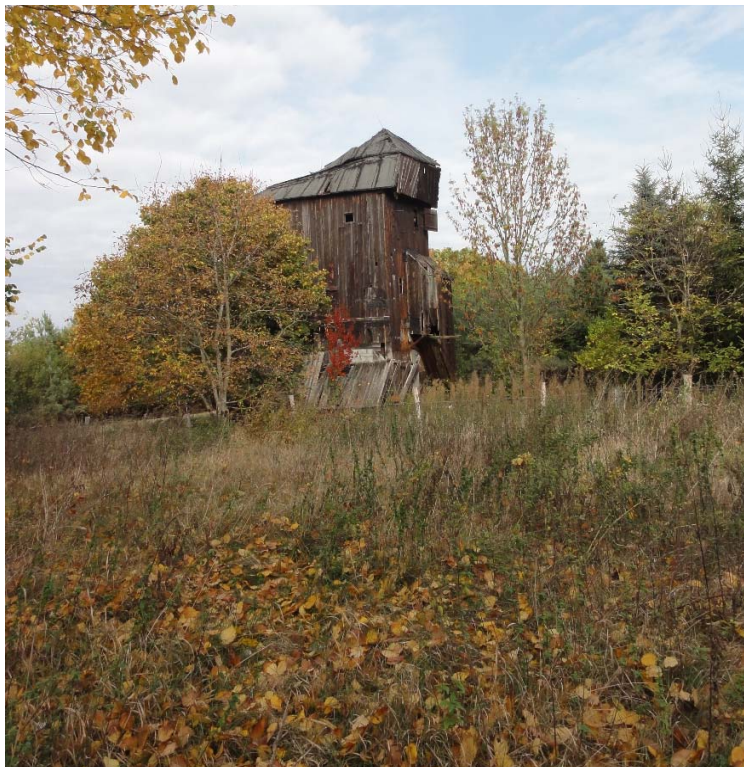
Abbildung 13: Marode Windmühle im westlichen Zentrum des Plangebietes, 19.10.2018
