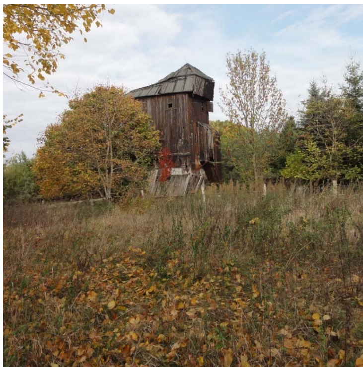
Abbildung 4: Marode Windmühle im westlichen Zentrum des Plangebietes, 19.10.2018
