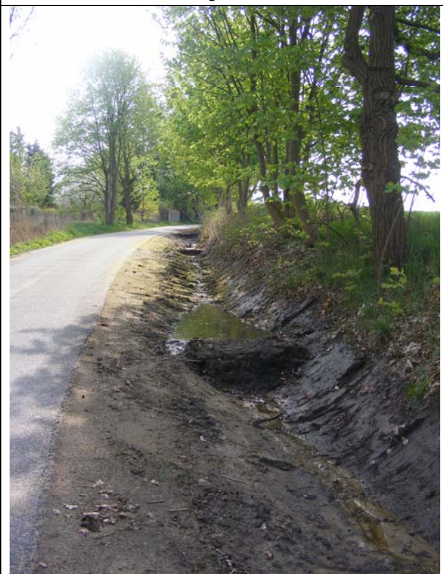
Vorhandene Regenwasserableitung „Am M¼hlenberg“
