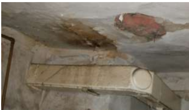
Abb.2.4.12-1 Raum Nr. 17- Küche Hofseite Leichter Feuchteschaden aus dem Dach mit Braunfäule, jedoch nicht statisch relevant (Abb. unten)
