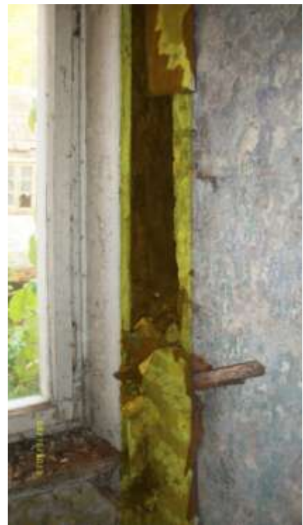
Abb. 2.4.3 desolater Fachwerk-Stil Außenwand VH zum Hof in der Trennwand Bad/Küche
