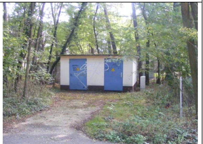
Dem Plangebiet BP W21 gegenüberliegende Bebauung – Trafostation
