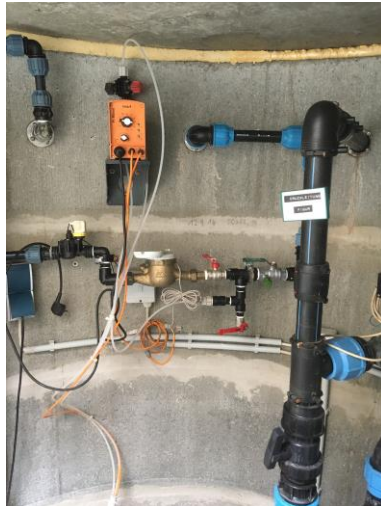
Bild 5 – Zähler mit Dosierung
