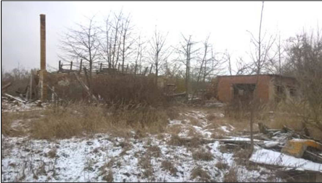
Abbildung 6-19: PL9 - brach liegendes Grundstück mit verfallenen Gebäuden und verstreut liegendem Unrat.
